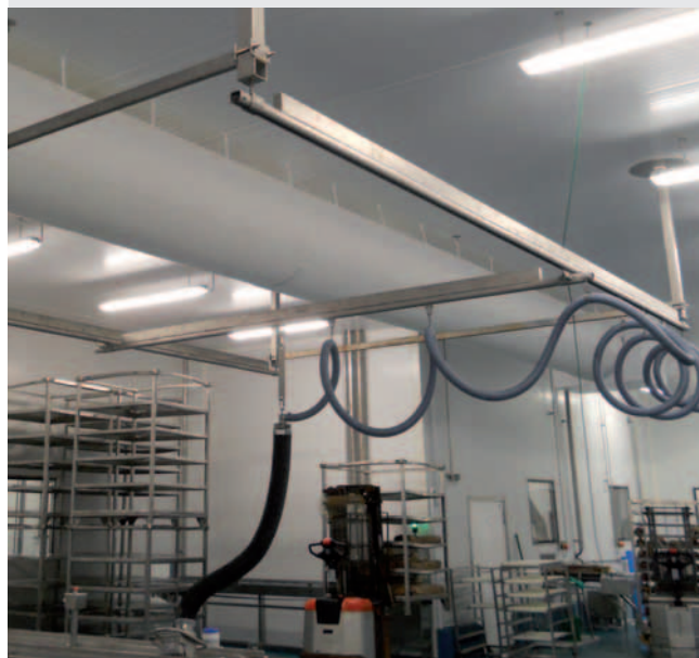
Pont roulant inox.
